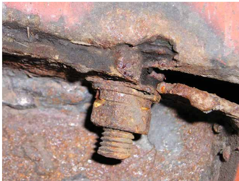
Рис. 2.5. Болтове з'єднання і пошкоджені корозією з'єднані елементи секції копнувача.
