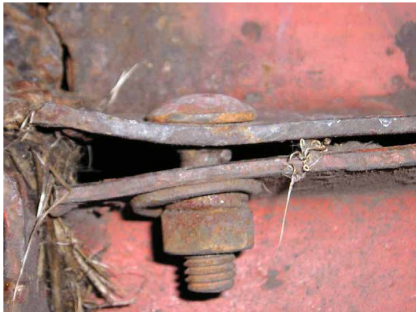
Рис. 2.2. Болт М12, який фіксує секцію подрібнювального апарата, зазнав деформації через надмірний осьовий натяг.
