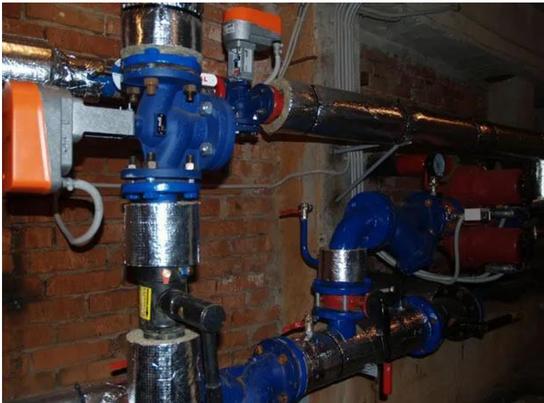
Рис. 2.6. Внутрішній вузол теплотраси
