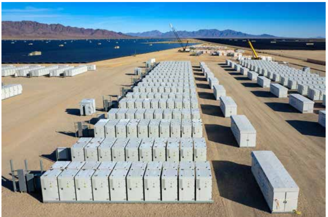
Рис. 1.5. Акумуляторні батареї для акумулювання електроенергії згенерованої сонячною електростанцією
