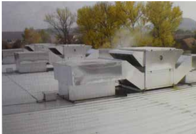
Рисунок 5.18. Загальний вигляд рекуператору теплоти у камері
