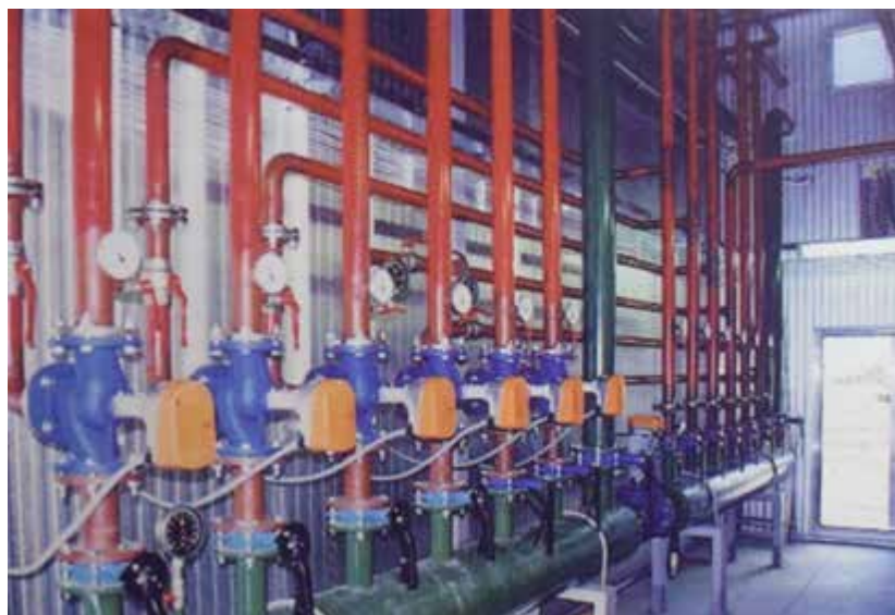
Рисунок 5.21. Трубопроводи та клапани для подачі гарячої води у камери
