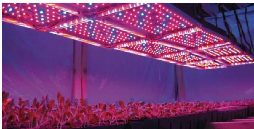
Рис. 1.13. Варіант встановлення світлодіодного освітлення в розсадному відділенні
