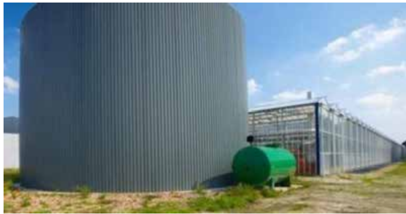
Рис. 1.8. Бак-акумулятор тепличного блоку
