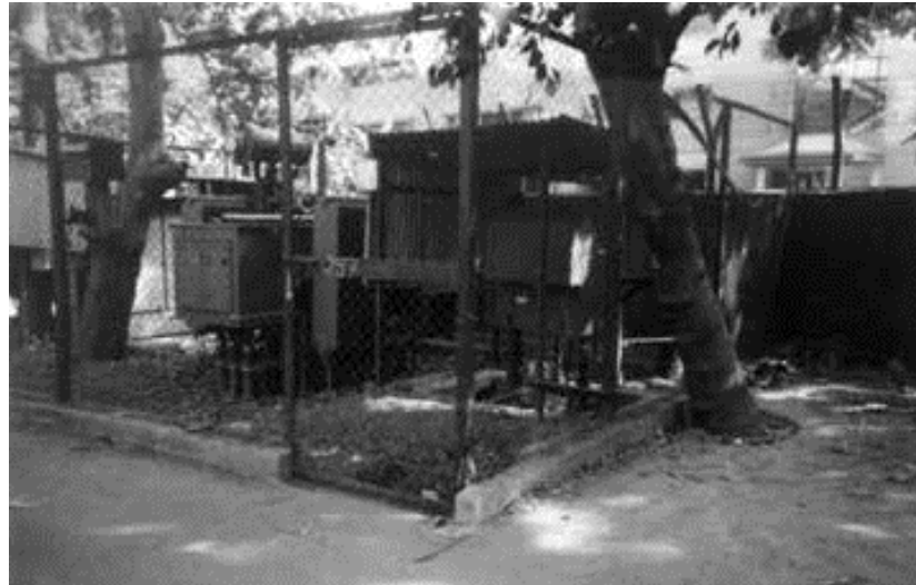
Рис. 2.29. Підстанція зовнішньої установки без корпусу.
