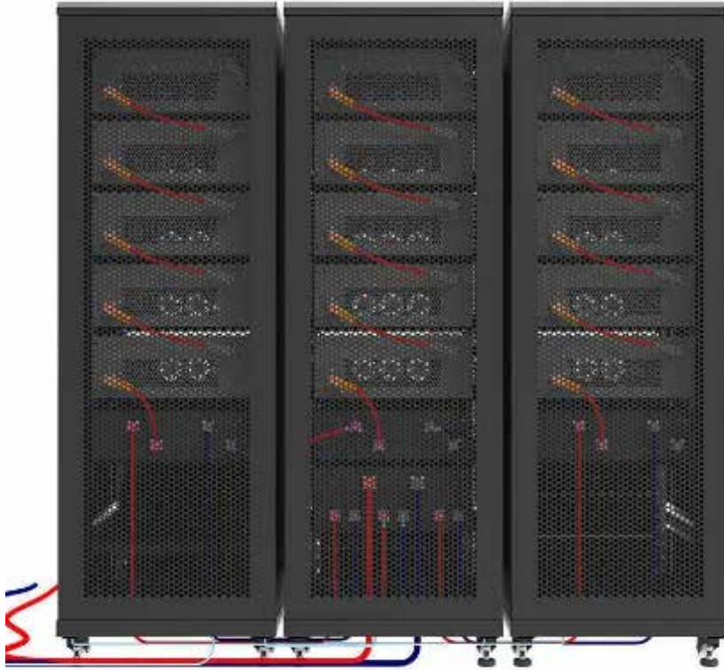
Рис. 3.4 Система акумуляторів LiFePO4 Enershare High Voltage
