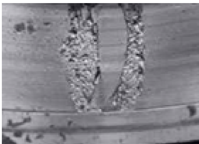
Рис.1. Контактно-втомне пошкодження - пітинг
