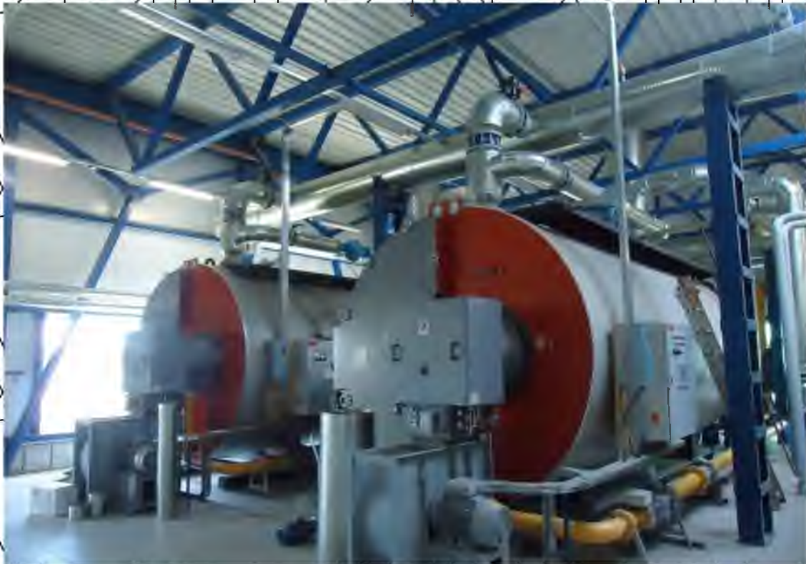
Рисунок 1.5 – Котел для системи опалення теплиці
