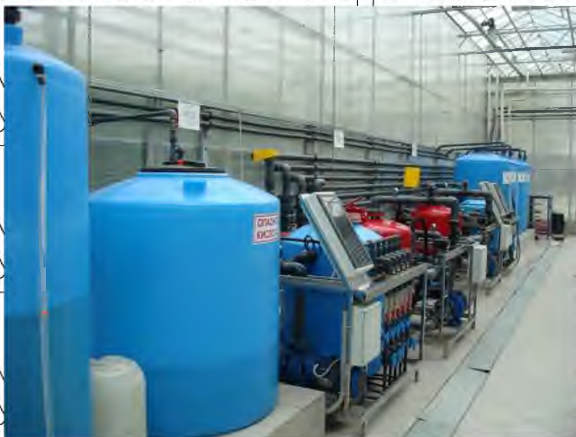
Рисунок 1.7 – Зрошувальне приміщення в теплиці
