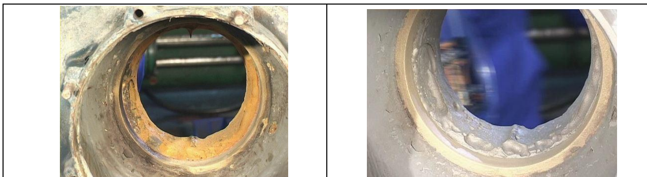
Рис. 1.4. Зношування внутрішньої поверхні равлика відцентрового насоса ОВТП
