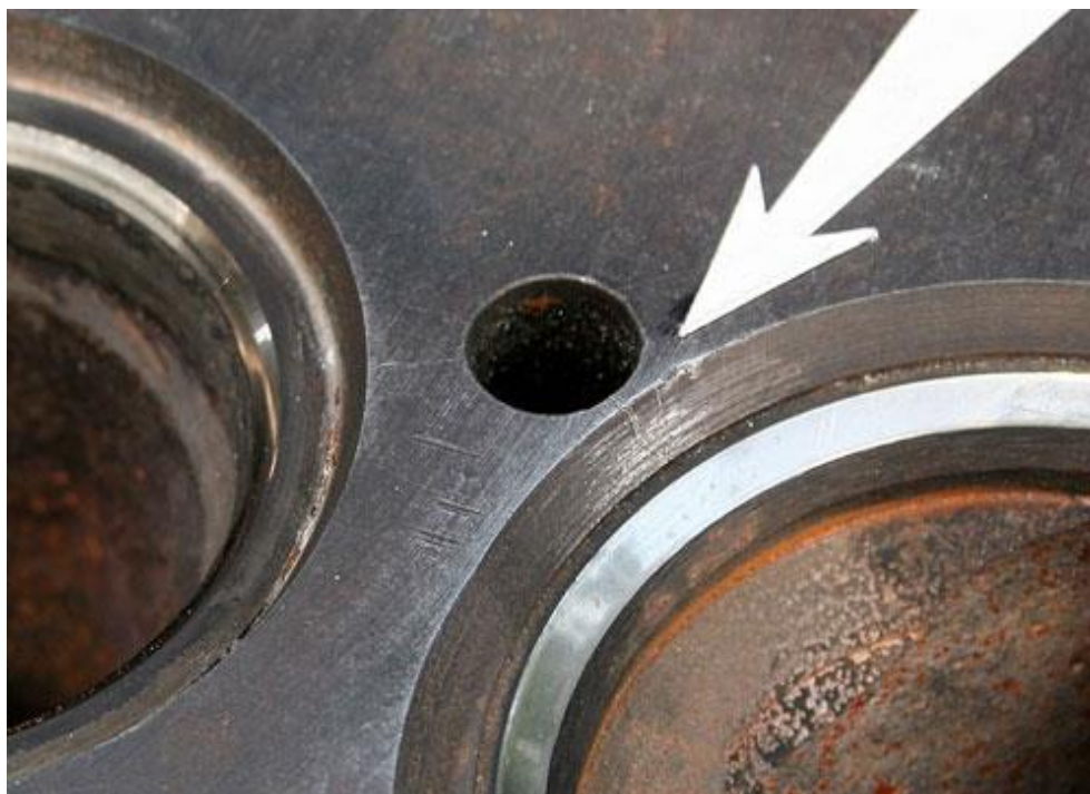
Рис. 1.23. Головка циліндрів до ремонту
