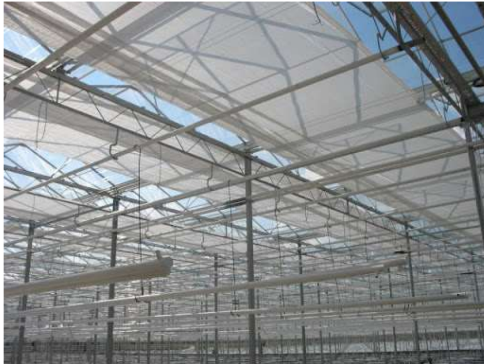
Рис. 1.12. Загальний вид системи зашторювання
