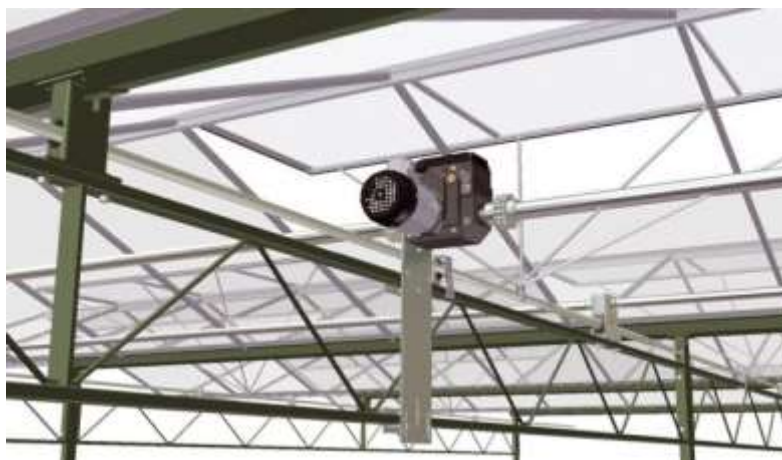
Рис. 3.13. Загальний вид мотор-редуктора в системі вентиляції в теплиці
