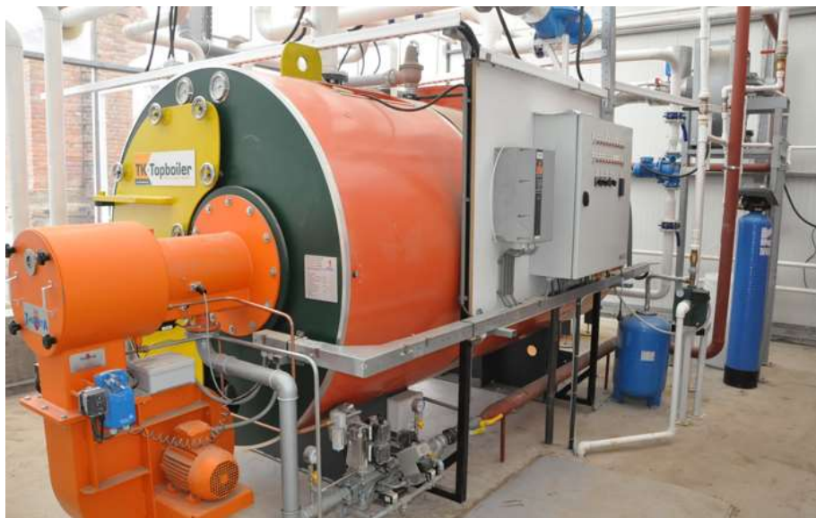
Рис. 1.4. Загальний вид котлу опалення сучасної теплиці
