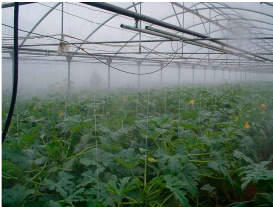
Рис. 1.7. Загальний вид системи штучний туман
