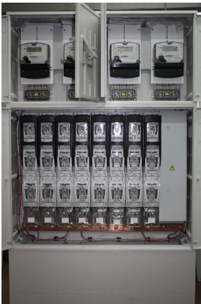
Рис. 1.1. Вигляд РП НН трансформаторної підстанції після реконструкція (на базі шафів силових розподільних типу СКУ).
