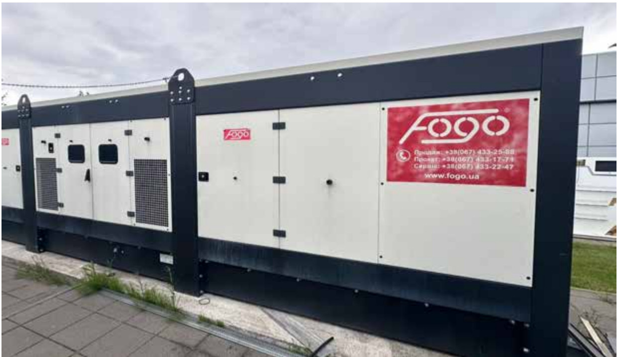
Рис. 2.3. Зовнішній вигляд генератора встановленого в кооперативі затишний.
