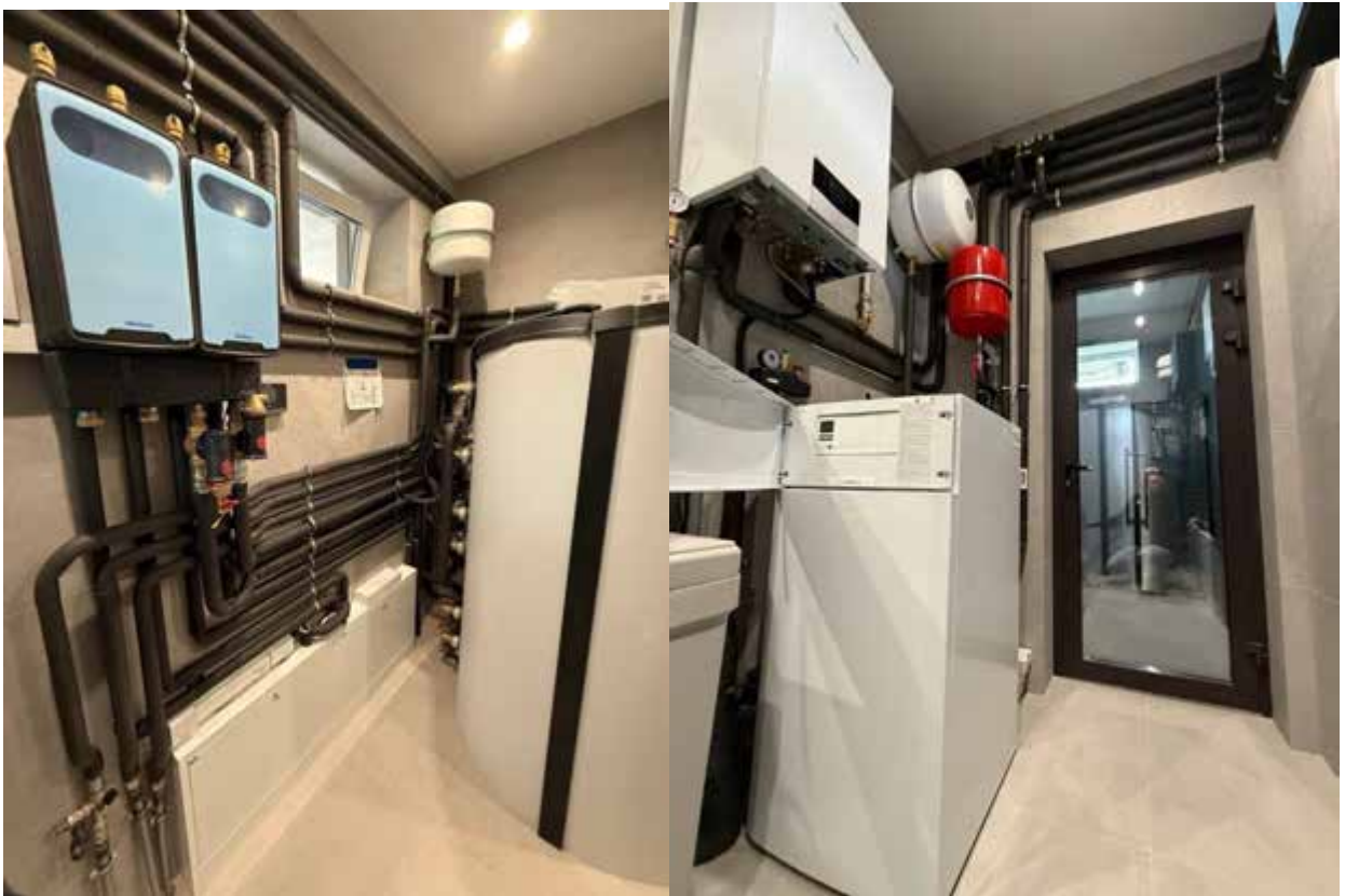
Рис.2.5 Зовнішній вигляд котельні з встановленими тепловими насосами
