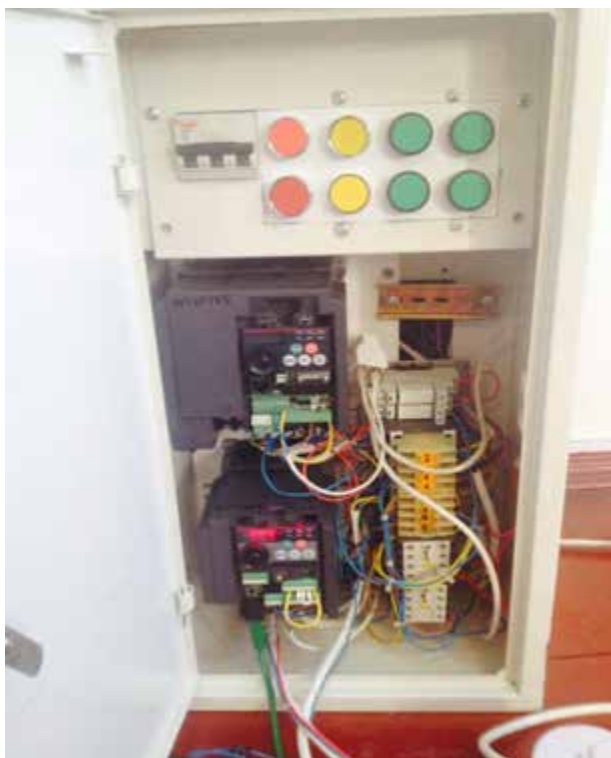
Рис. 7.3. Щиток з частотним перетворювачем для автоматичного керування електродвигуном
