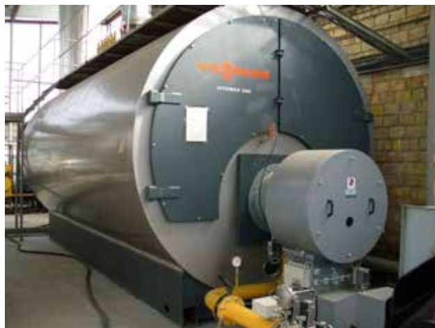
Рис. 1.6. Водогрійний котел Viessmann типу Vitomax 200 WS (ПАТ Комбінат "Тепличний")
