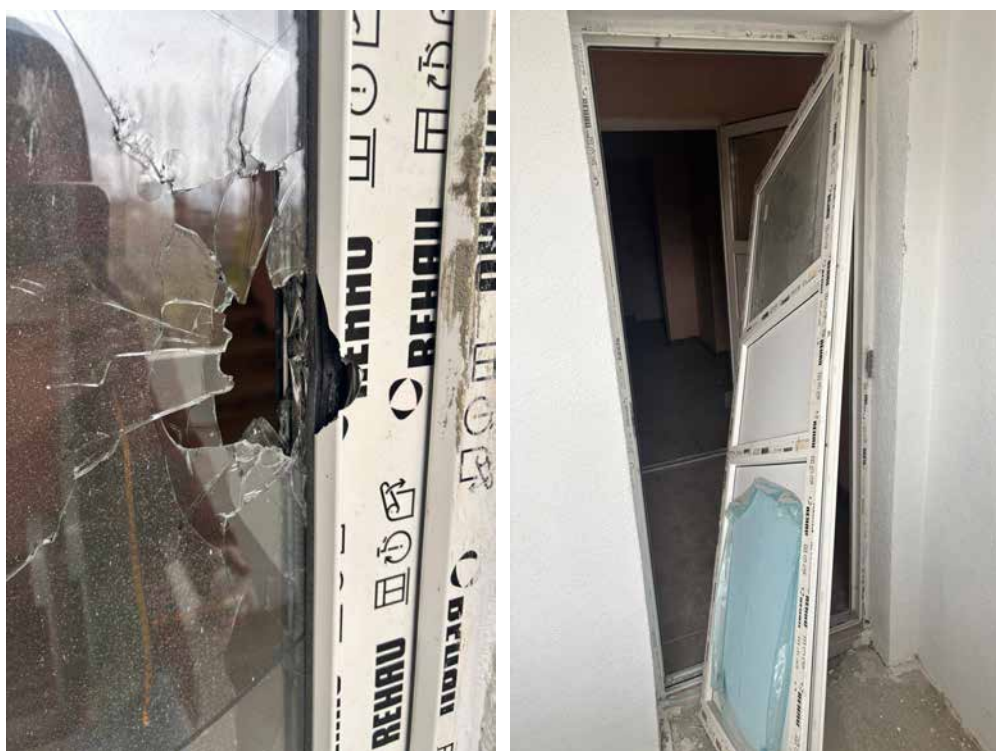
Рис. 2.4. Зафіксовані пошкодження (власна фотофіксація)
