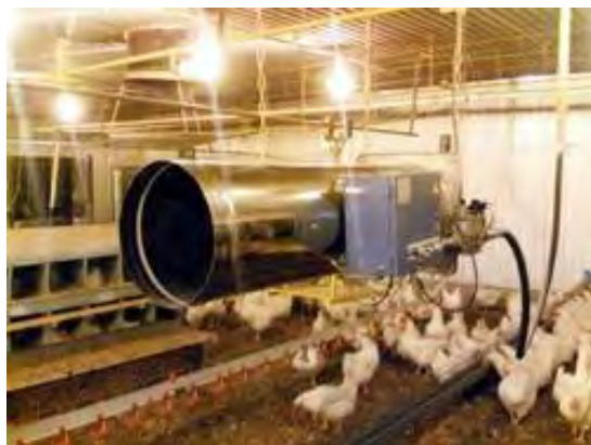
Рис. 2.17. Застосування газового теплогенератора для обігріву
