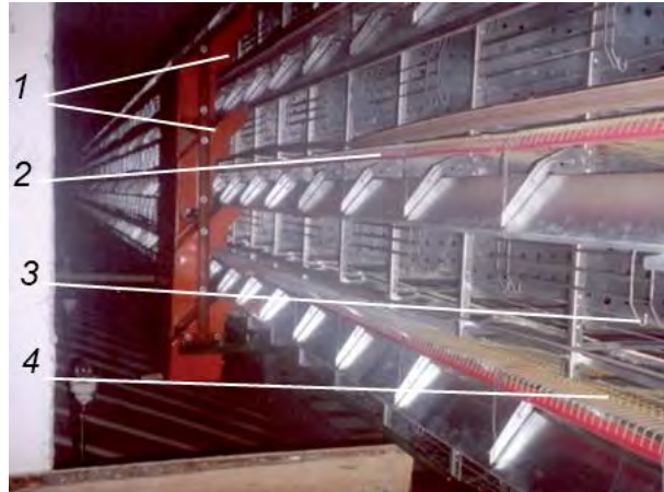
Рис. 1.23. Загальний вигляд кліткової батареї БК-143
