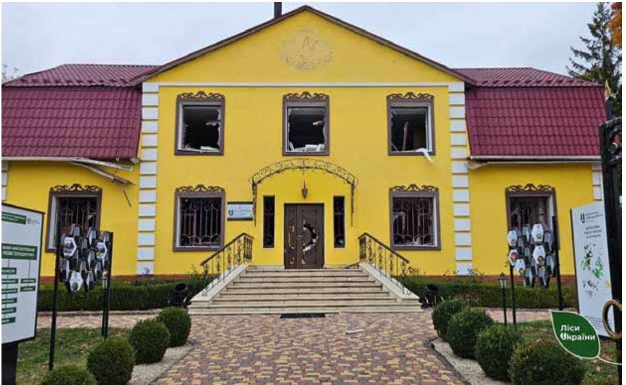
Рис. Постраждала будівля офісу Краснопільської філії ДП «Ліси України», що на Сумщині наприкінці жовтня 2024 р.
