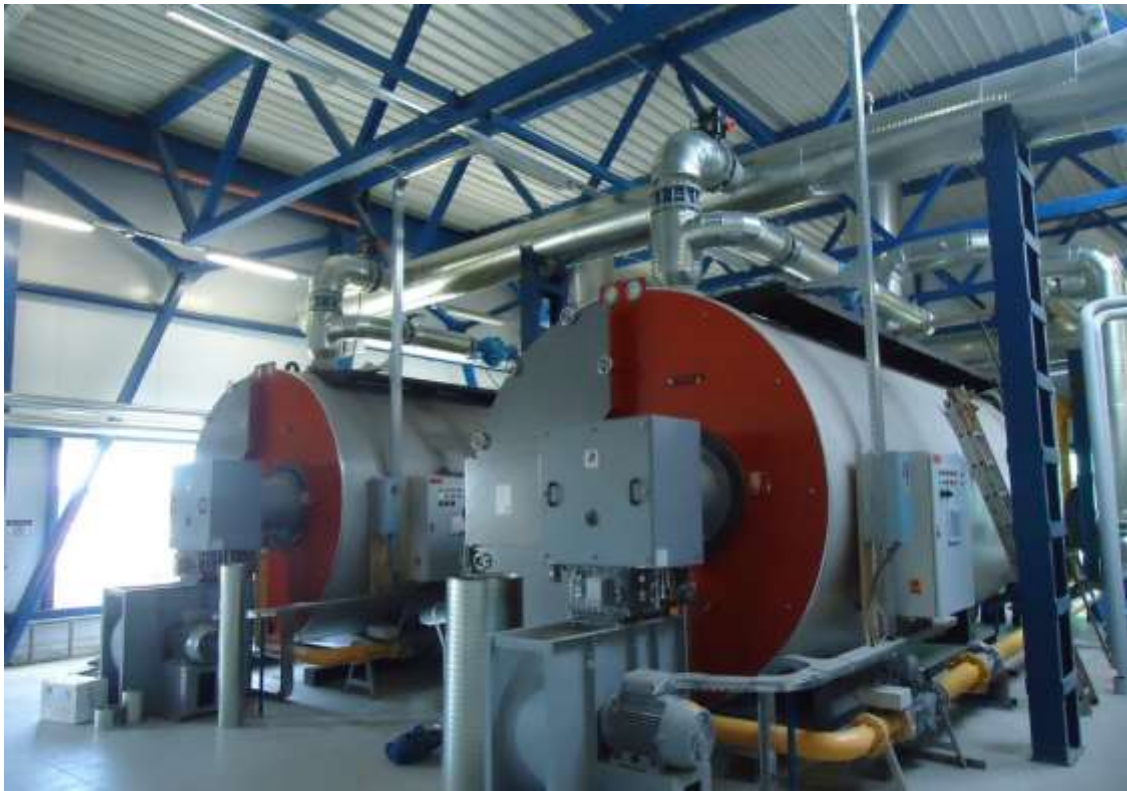
Рисунок 1.5 – Котел для системи опалення теплиці
