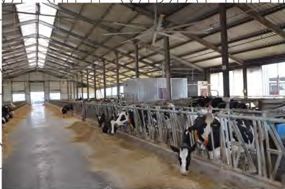
Рис.3.1.3. Система примусово- природньої вентиляції в приміщенні виробничій секції де утримують дійних корів
