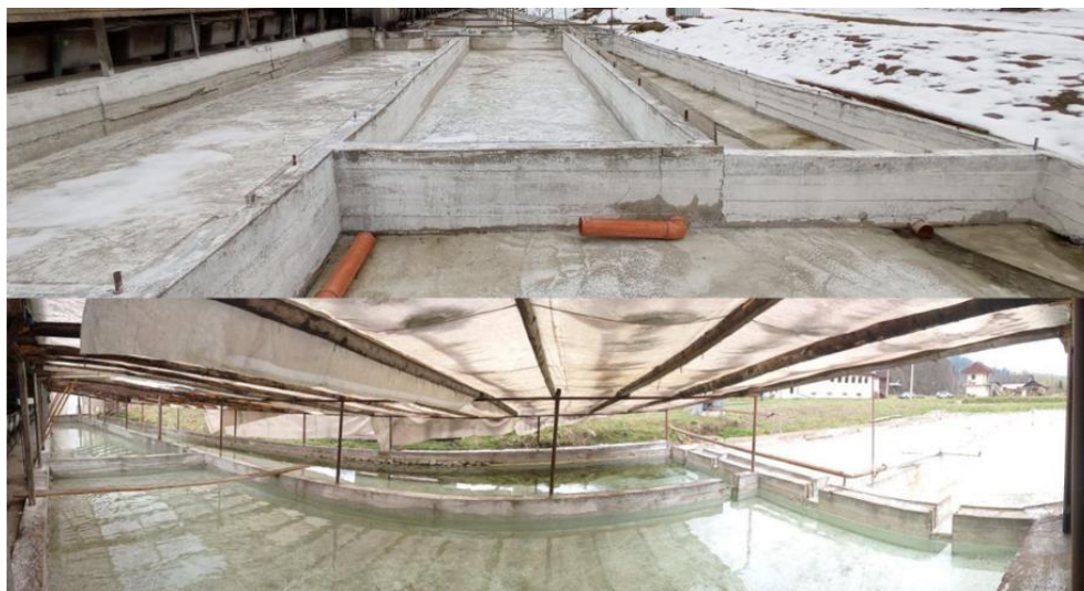
Рис. 3.7. Літні бетоновані маточні басейни (власні фото)
