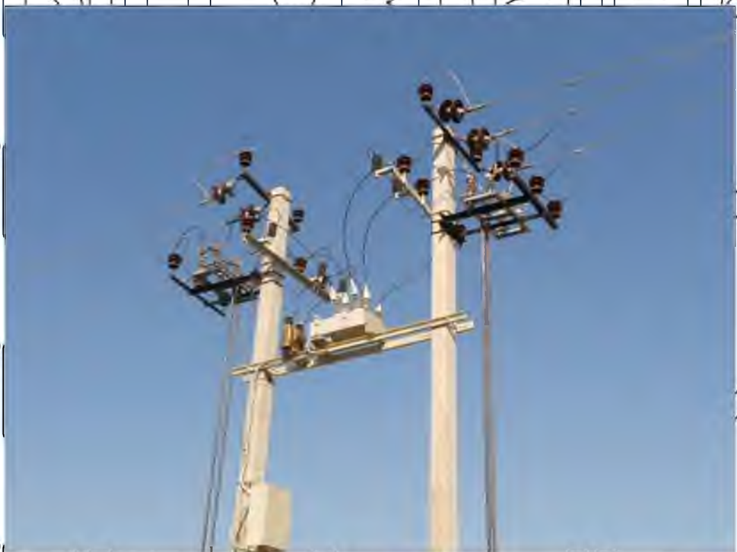
Рис. 3.3 Зовнішній вид вакуумного реклоузера типу РВА/TEL-10-12,5/630.
