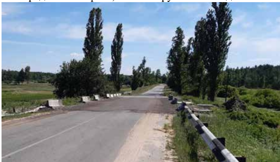
Рис. 2. Фрагмент зруйнованого мосту
