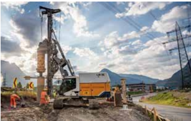
Рис. 1. Електрична бурова установка «LIEBHERR»
