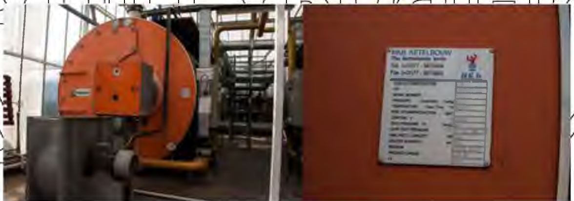
Рис. 1.4. Загальний вигляд водогрійного котла
