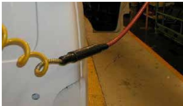
Рис. 19 а Металевий штуцер не ізолюваний
