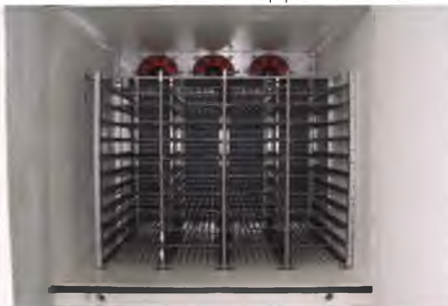
Рис. 1.3. Загальний вигляд камери для шоквої заморозки ягід суниці
