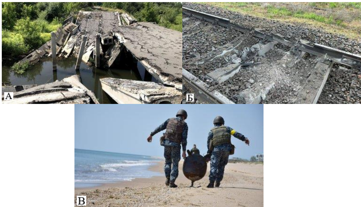
Рис. 1.4. Наслідки ворожих дій російської федерації проти української транспортної інфраструктури: А) пошкоджений автомобільний міст; Б) пошкоджена залізнична колія; В) заміноване морське узбережжя.
