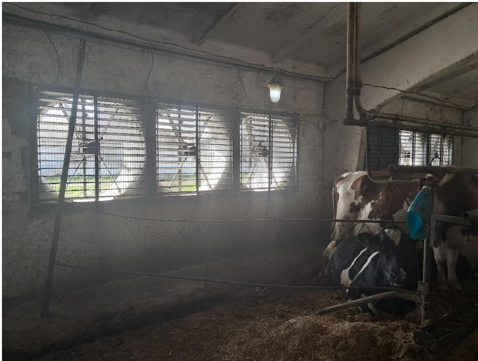
Рис. 3.3. Вентиляційна система (фото автора)
