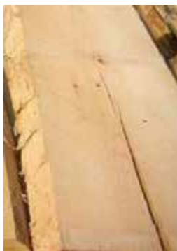
Рис. 1.12. Деформація деревини – тріщина [11]
