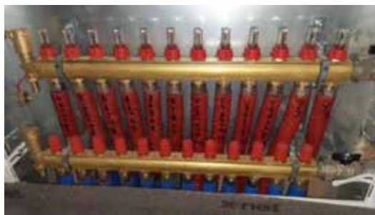
Рис. В.25. Зовнішній вигляд колекторної шафи з гребінкою теплої підлоги
