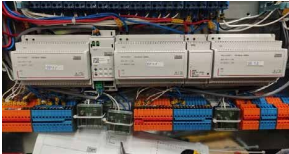
Рис 3.11. Зовнішній вигляд шафи керування освітленням (блоки живлення та контактні інтерфейси MuHome)
