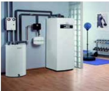
Рис. 3.15. Повітряний Тепловий насос
