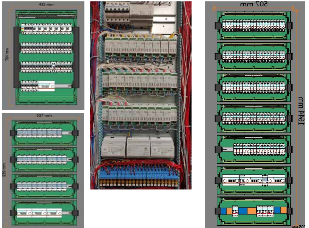
Рис. Б.36. Шафа автоматизації освітлення (Проект + монтажна частина)
